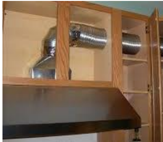
Kitchen exhaust fan
